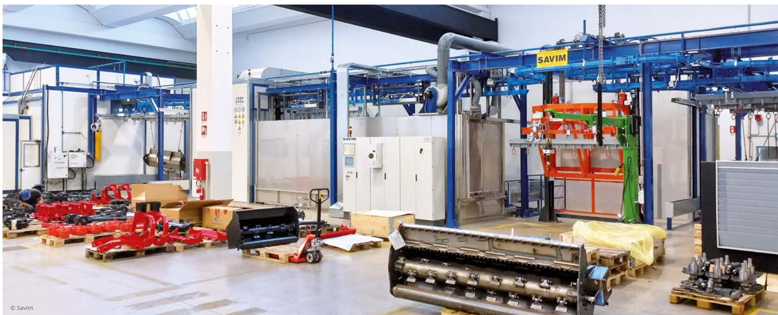
Vista panoramica dell'impianto installato da Savim Europe.
