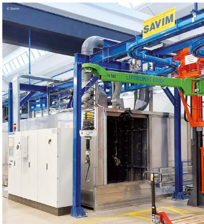
L'ingresso del tunnel di pretrattamento.
