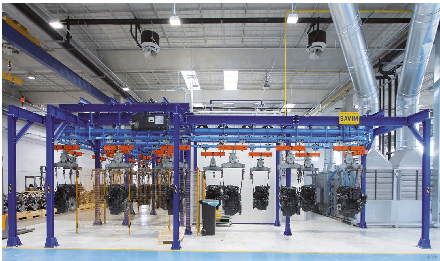
L'area di carico e scarico dell'impianto automatico progettato da Savim di Arbizzano, Verona, con convogliatore CM Automazione di Giussano, Monza.
